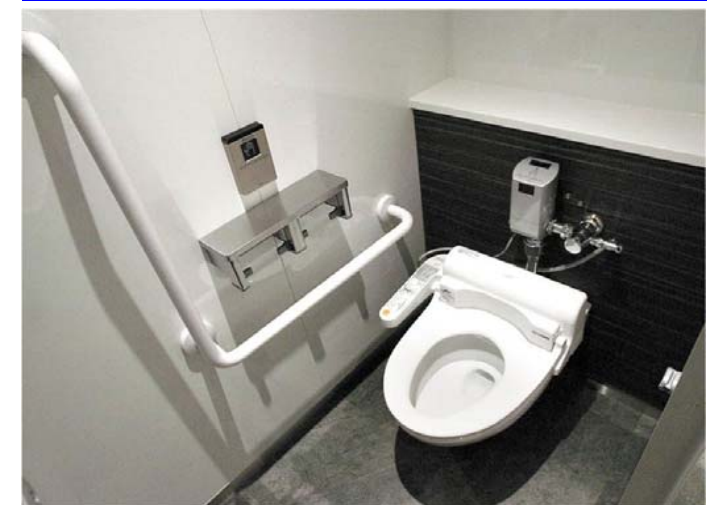
L型手すりを設置したブースを設けると共に、自動フラッシュバルブを選定し、使いやすさと節水性の両立を図っている。
