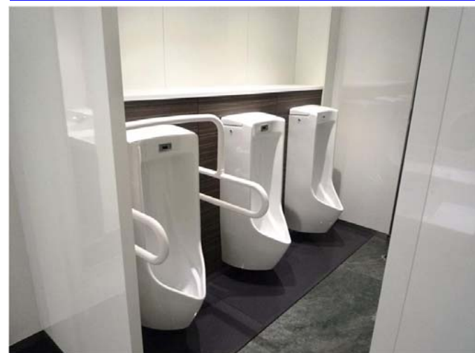
器具数を増やすことで、サービス性を向上。同時に手すりの設置と奥行きのあるライニングを採用し、使い勝手にも配慮している。
