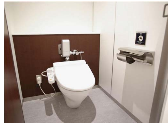
小物も置ける奥行きのある大便器ライニングを採用。自動フラッシュバルブを選定し節水性に配慮している。
